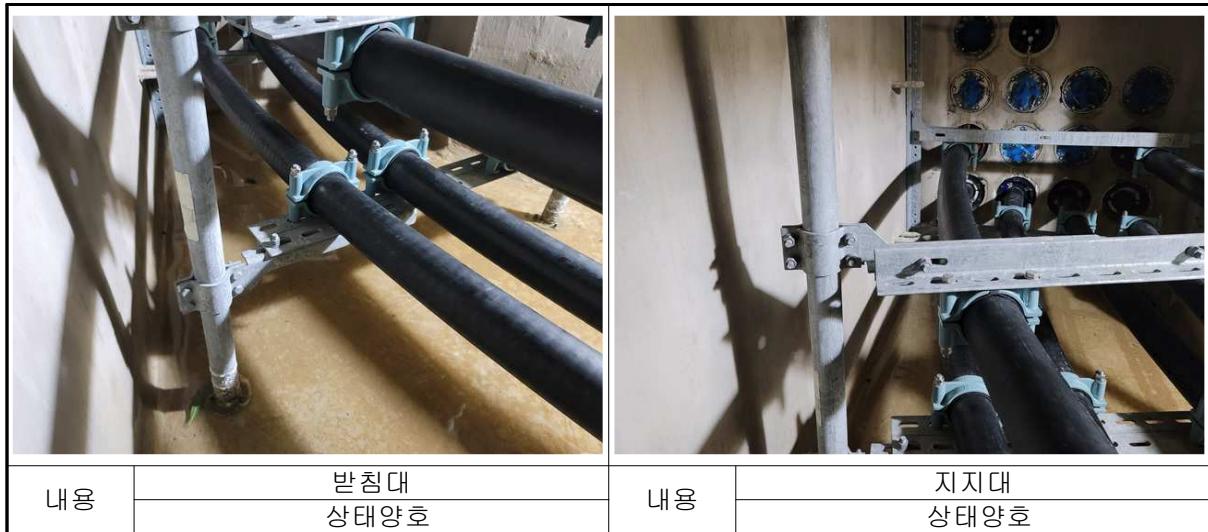
【사진 4.8】 부속 및 부대설비 현황
