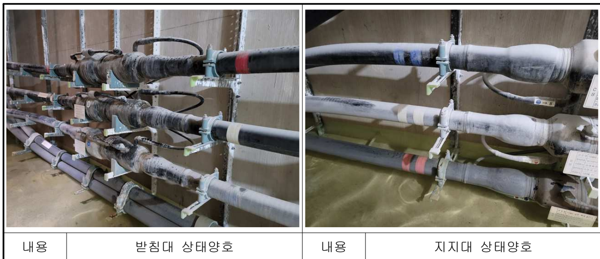
【사진 4.56】 부속 및 부대설비 현황
