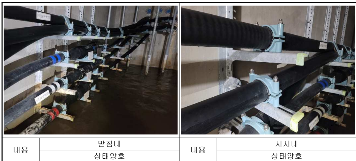
【사진 4.20】 부속 및 부대설비 현황
