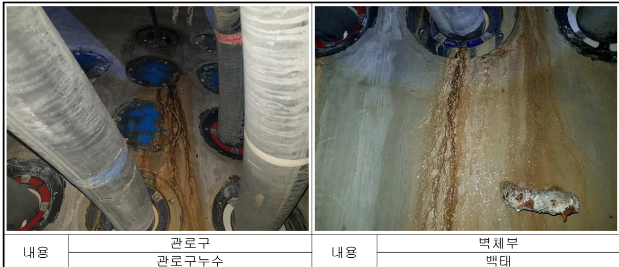
【사진 4.14】 맨홀 내부 주요 손상
