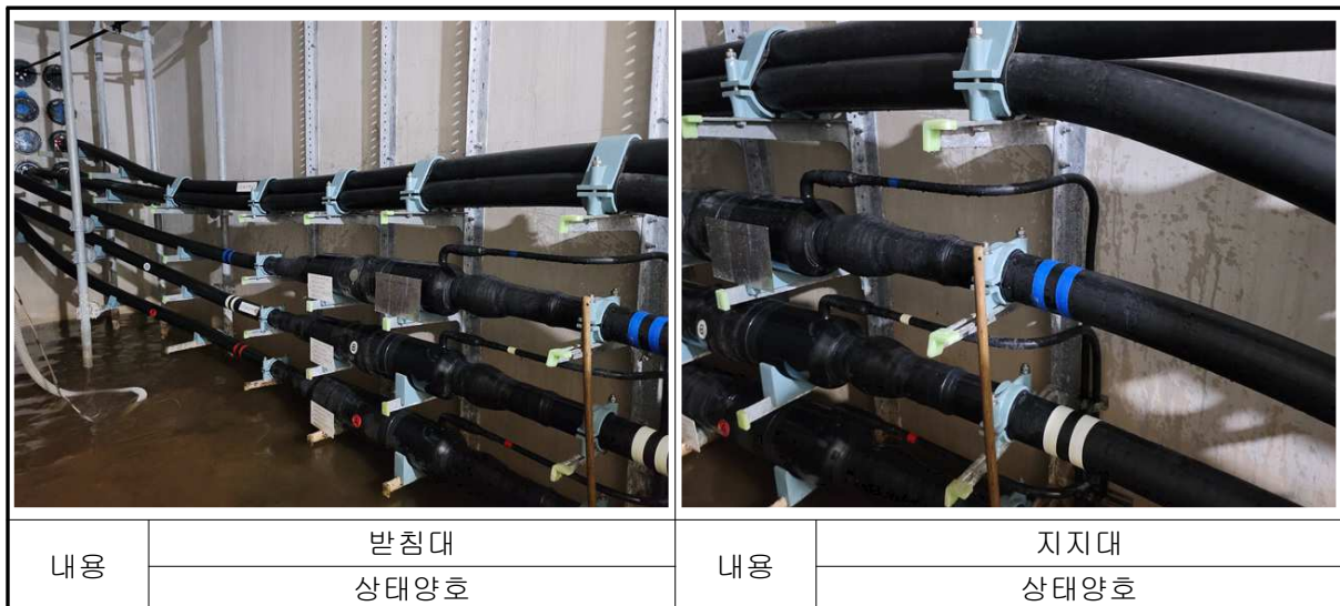
【사진 4.32】 부속 및 부대설비 현황
