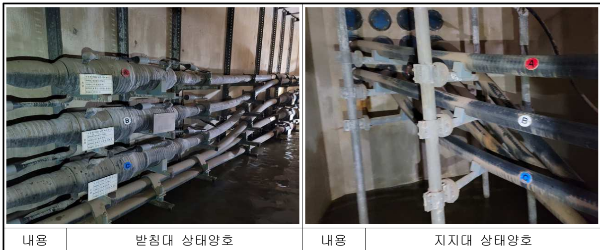
【사진 4.48】 부속 및 부대설비 현황
