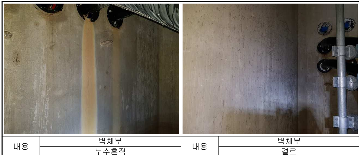
【사진 4.70】 맨홀 내부 주요 손상
