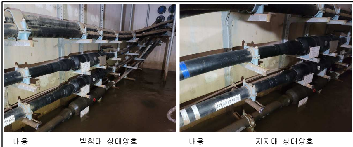
【사진 4.44】 부속 및 부대설비 현황
